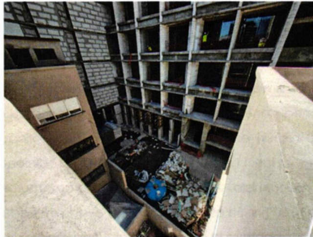
Imagen 2. Parte trasera del edificio sin malla de protección, señalada por vecina.
