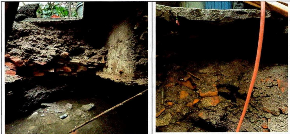
Imagen 1. Fotografías del socavón después de la extracción del agua.
